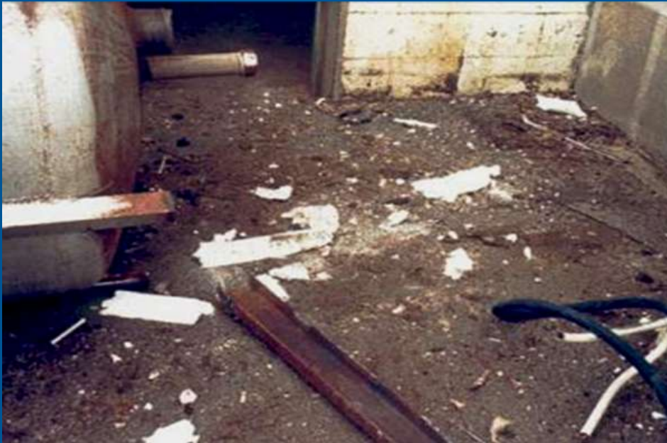
Deseuri de azbest pe un santier de demolare
