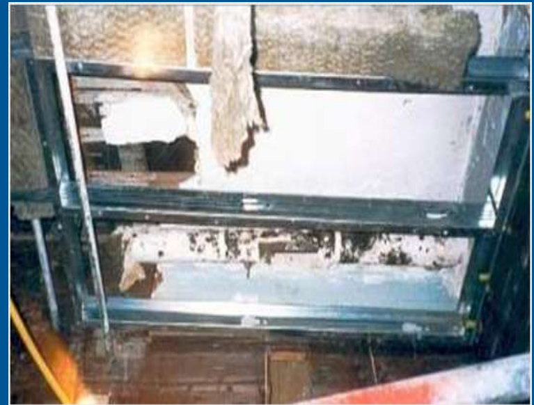
Izolatii pentru tevi degradate
